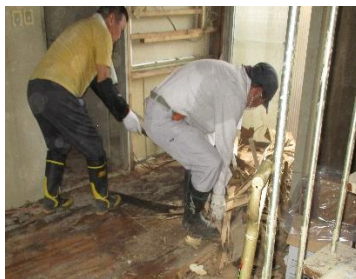
平成30年8月岡山県真備町
